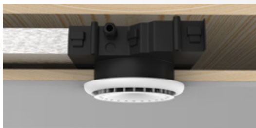
Bild 7: Einbau und Leitungsführung in abgehängter Decke mit Flachkanalanschlussgehäuse (FKAG) 200/150 x 40 mm. (Quelle: air-lab GmbH)
