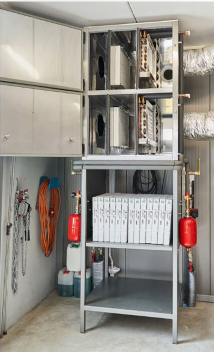
Bild 23: Sole/Luftwärmepumpen (inklusive großformatige automatische Bypassklappen). (Quelle: air-lab GmbH)
